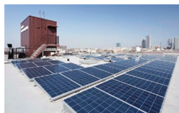
▲屋上に設置された太陽光発電モジュール
